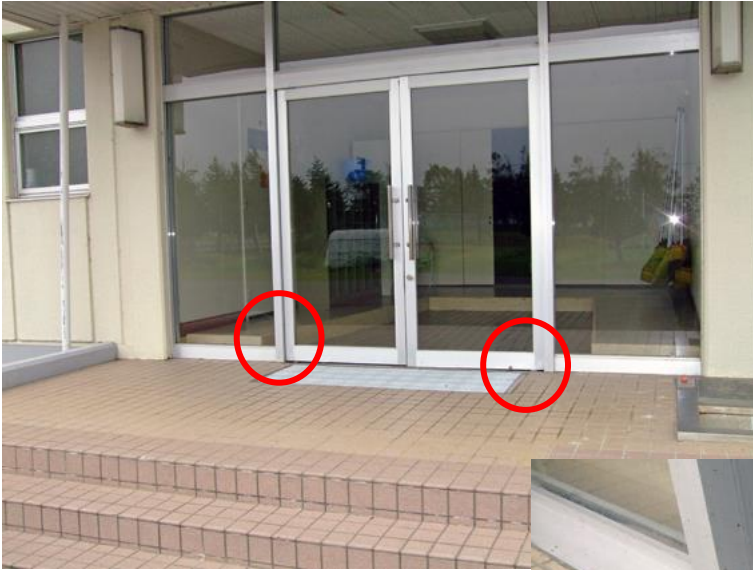
体育館玄関ドア左側 ↓
